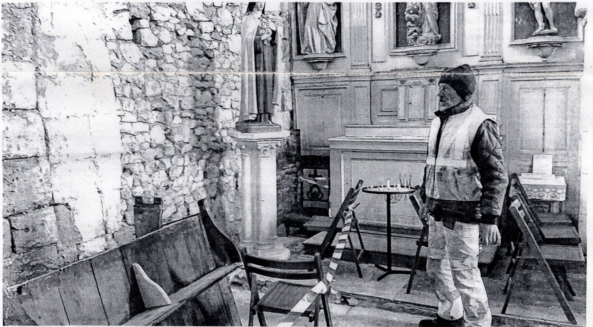
La mérule s'est attaquée aux boiseries à l'intérieur de l'église. Les employés municipaux ont dû mettre à nu les pierres en enlevant le mortier. La société BMT de Noyon a ensuite pu intervenir pour appliquer le traitement ad hoc.
